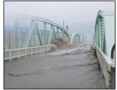
台風第12号による冠水 (国道42号 新宮市(県境部))
